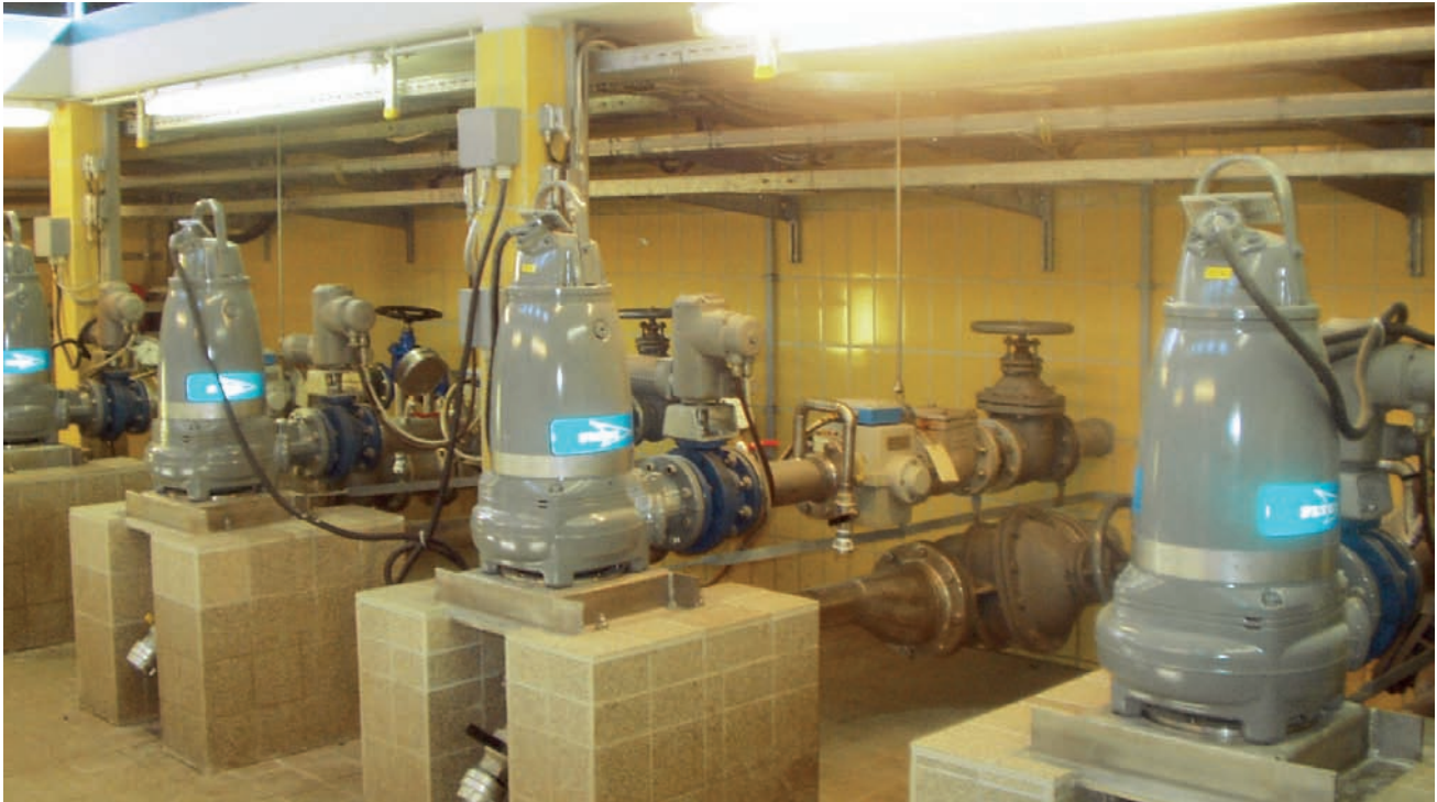
Verstopfungsfreie Rückschlammförderung mit insgesamt 24 N-Pumpen
