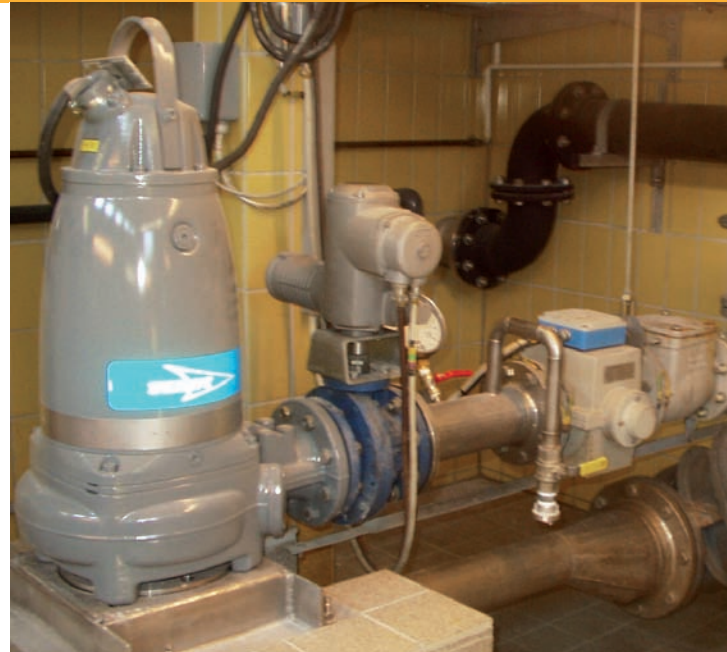
Die trocken aufgestellte N-Pumpe überzeugte im Vergleichstest.
